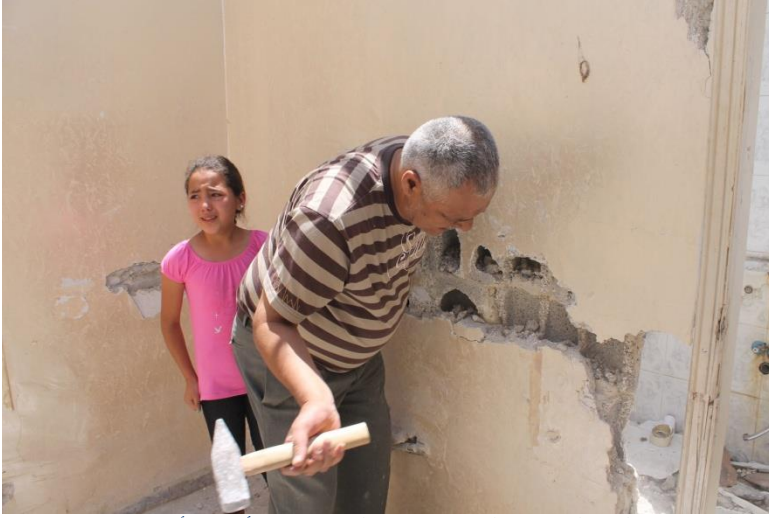
بلدية القدس تجبر والدها على هدم منزله وابنته تراقب. المصدر: مركز أبحاث الأراضي.
